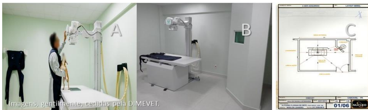
Figura 1: Sala de raios X padrão ANVISA seguindo a RDC 50/02 e 330/19 da ANVISA.
